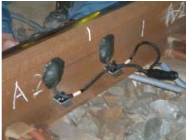
図-5 ひずみゲージのレール貼付状況
