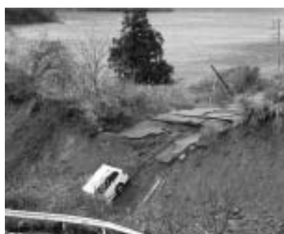
■写真—2 崩壊した道路
